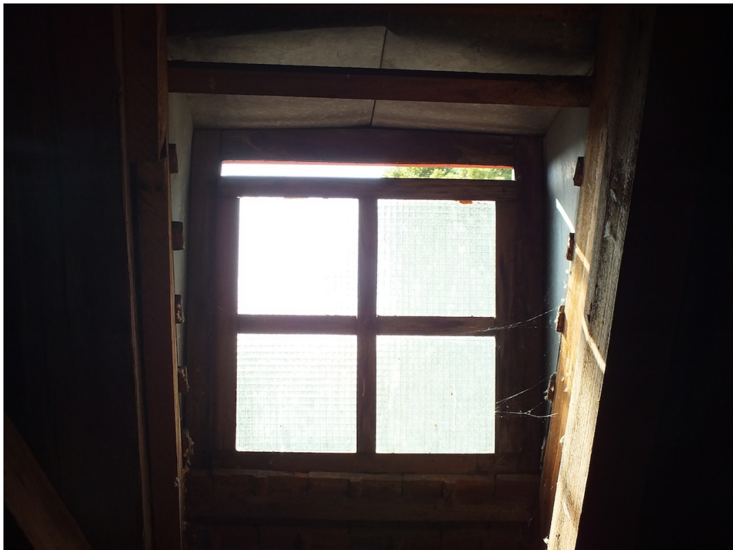
Abb. 7 Dachbodenfenster mit Zugang für Fledermäuse (Spalt oben) im Schloss Orth
