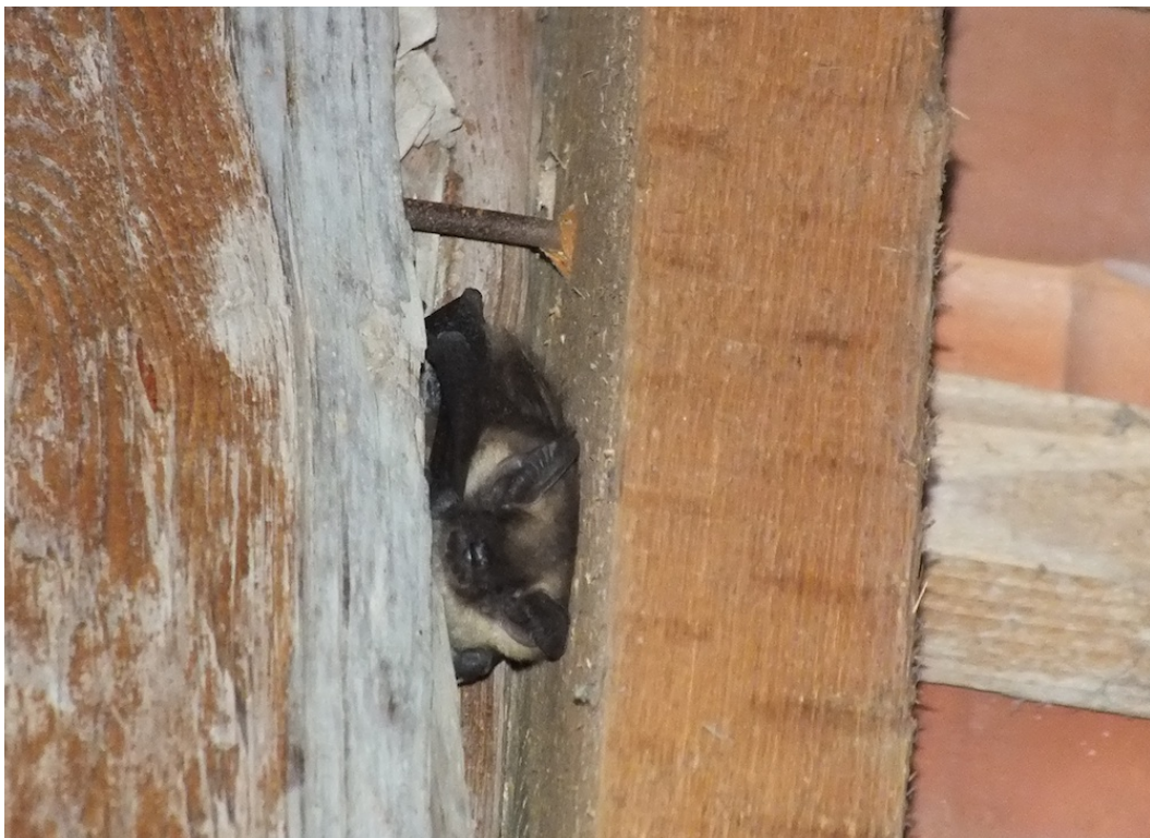
Abb. 5 Breitflügelfledermaus versteckt in einer Spalte am Dachboden
