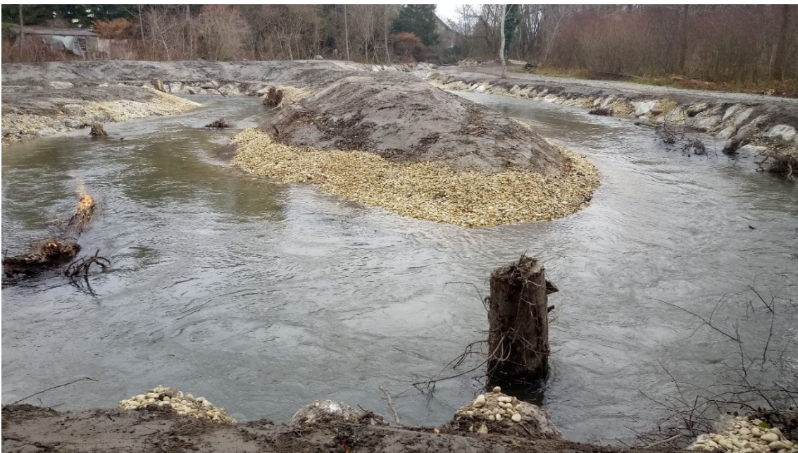
Abb.15: Umgehungsarm "Biberfalle" © EZB
