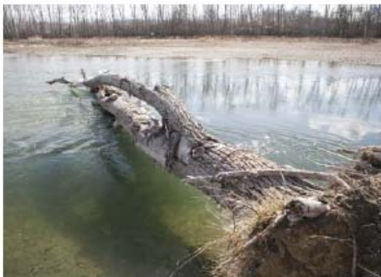
Umgestürzter, mit Stahlseil in der Uferböschung fixierter Stamm, © ezb
