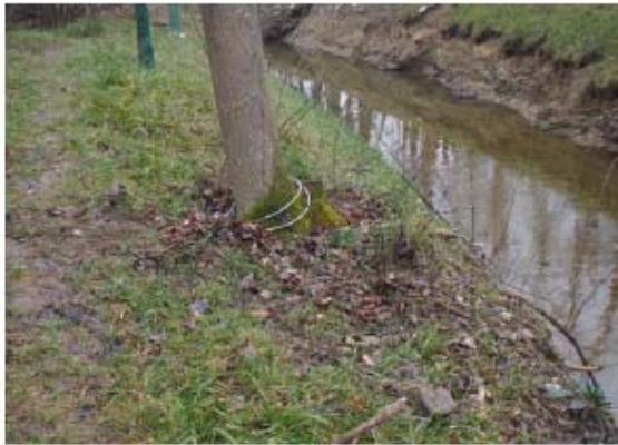
Mit Stahlseil und Erdanker befestigtes, erosionsgefährdetes Ufergehölz, © ezb
