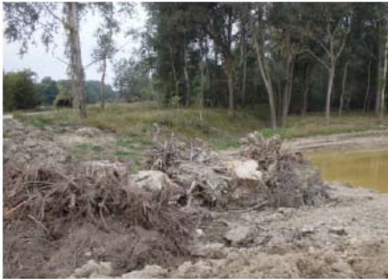
Stöcke von Pappeln, Weiden und Erlen sind im gewässernahen Bereich besonders geeignet, © ezb
