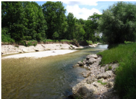
Tolerierter Uferanriss an der Ybbs, Freilandstrecke, © ezb
