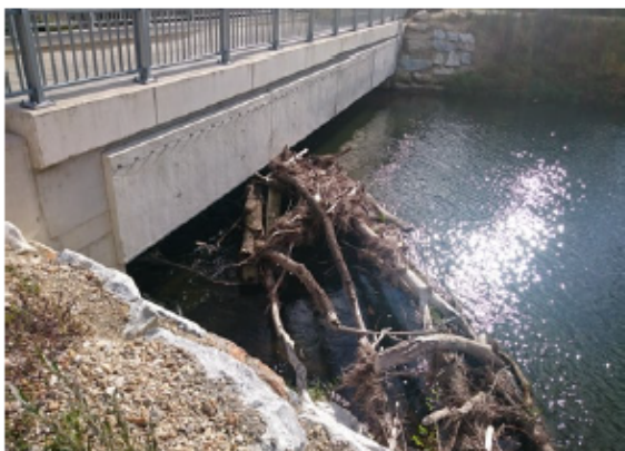
Verklausung an einem Drosselbauwerk, © ezb
